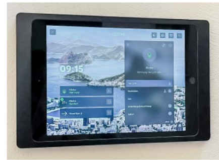
Die Steuerung – z.B. über die Loxone-App – ist einfach und übersichtlich.
